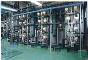
砂ろ過・活性炭吸着塔設備
