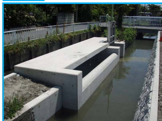
水位上昇時に余水を吐き出す施設
