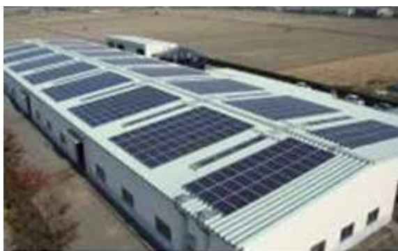
〔屋根貸し太陽光発電（めめま有機センター）〕
