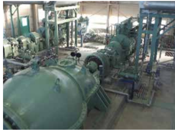
〔排水機場ポンプ設備〕
