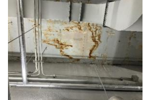
機械設備(ポンプのさび)
