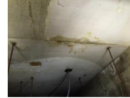
天井裏(雨漏り)
