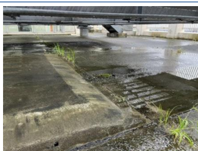
屋上(目地の劣化)
