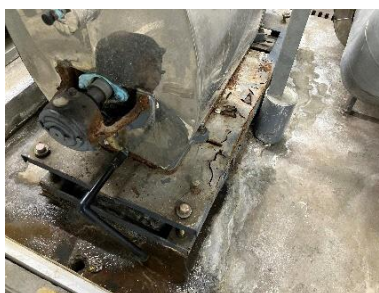
機械設備(配管劣化)
