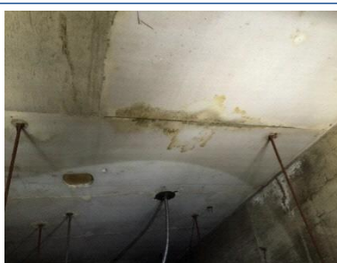
天井裏(雨漏り)
