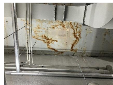
機械設備(ポンプのさび)
