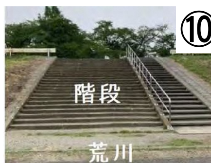
階段 荒川 バリアフリーなアクセスを損ねる階段 市民体育館前（堤外側） （高低差4m程度）
