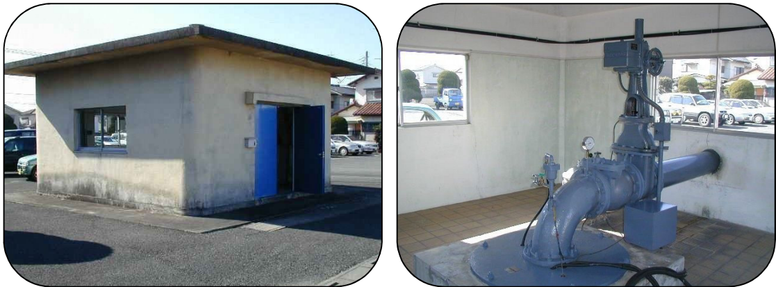
図 3-2.水源施設（東部1号取水井）
