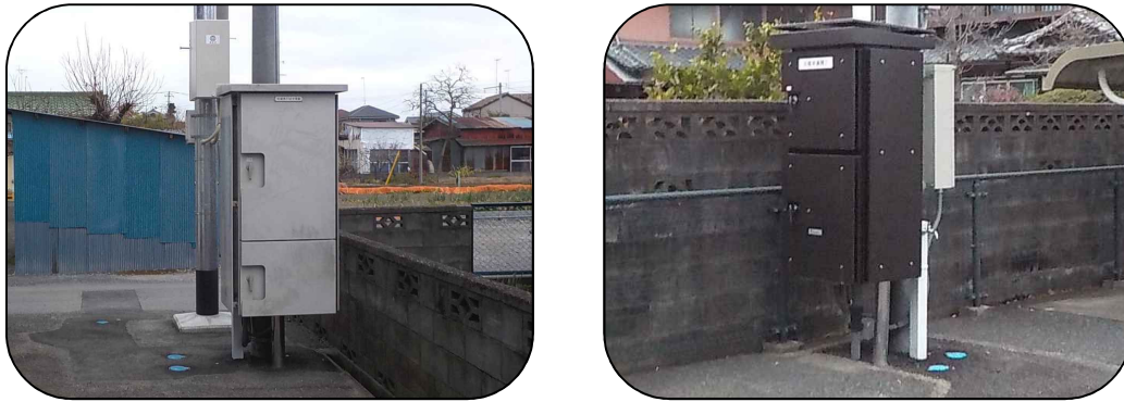
図 3-5.末端監視装置
