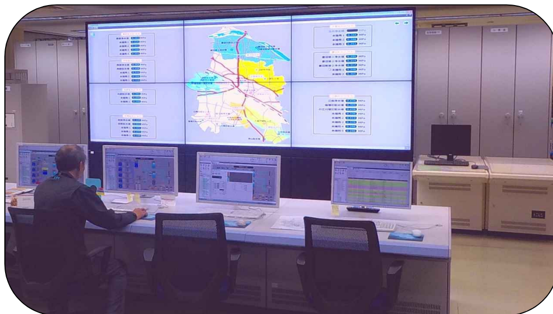
図 3-3.中央監視設備（東部浄水場）
