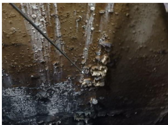
処理施設（水槽内の劣化）
