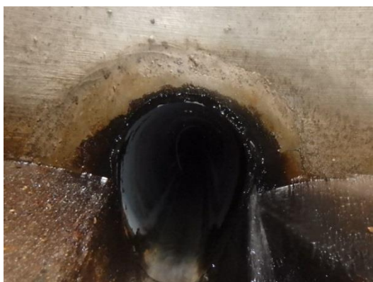
管路施設（管口の劣化）
