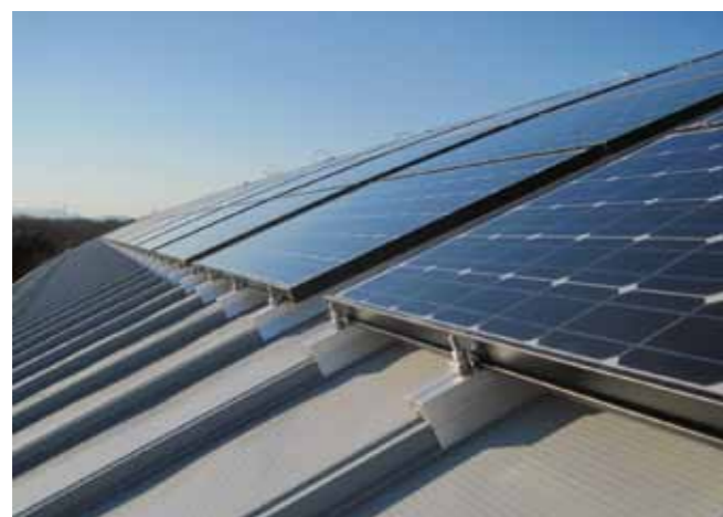
吉岡中学校に設置した太陽光発電設備
