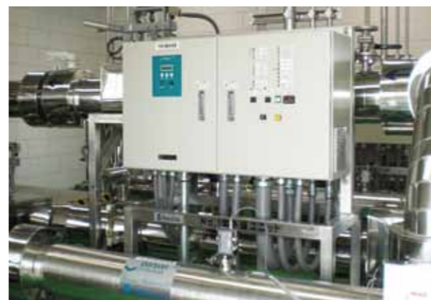
吉岡浄水場の紫外線処理設備
