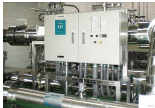
吉岡浄水場の紫外線処理設備
