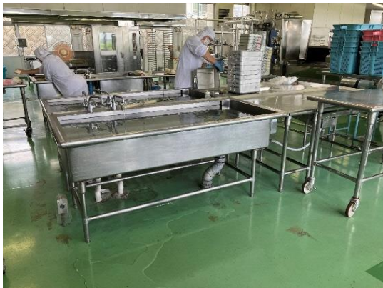
調理室（設備の老朽化、水漏れあり）
