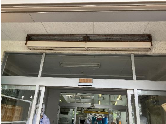
食材搬入口（設備の故障あり）
