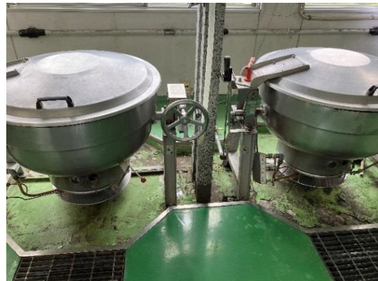
調理室（一部で雨漏りあり）
