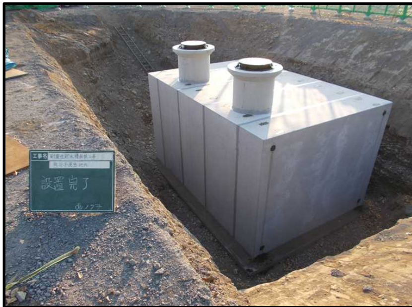
平成29年12月に総務省補助金の交付を受けて 熊谷市スポーツ・文化村「くまぴあ」に設置した耐震性貯水槽
