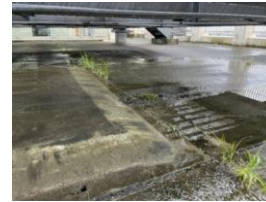
屋上(目地の劣化)
