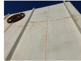
屋上(外壁のひび割れ)
