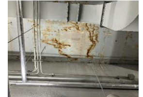
機械設備(ポンプのさび)
