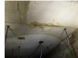
天井裏(雨漏り)
